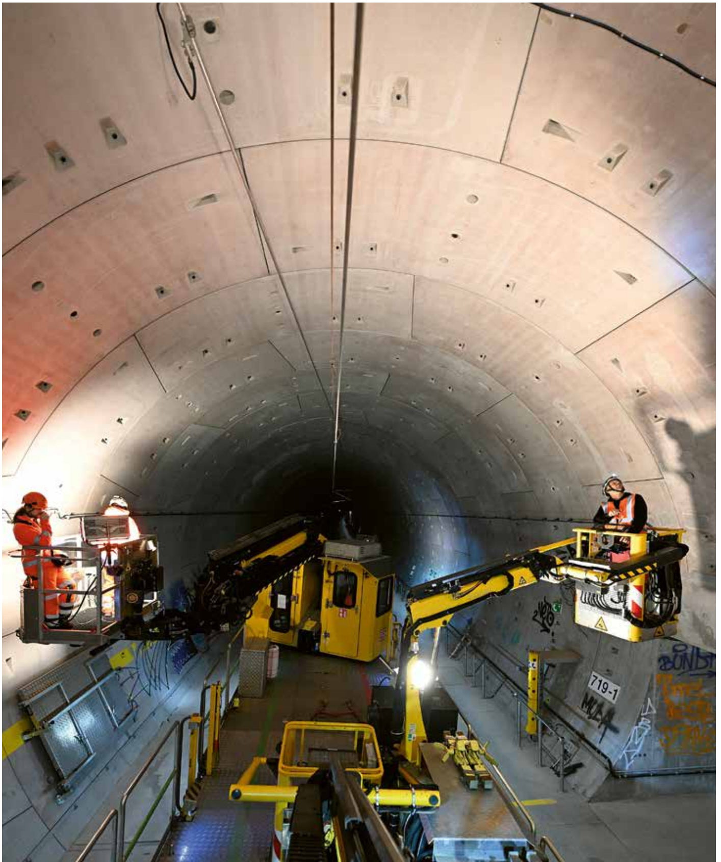
Das Tunnel-Instandhaltungs-Fahrzeug der Deutschen Bahn, kurz TIF, ermöglicht eine effektive Untersuchung der Betonwände.
